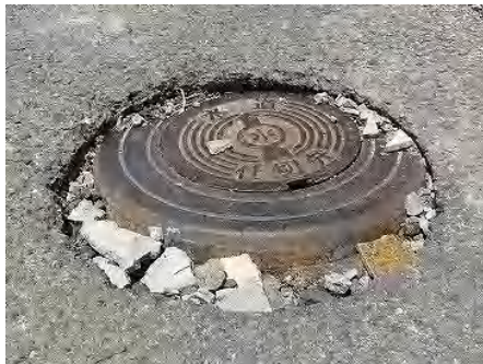
鉄蓋や舗装のずれ
